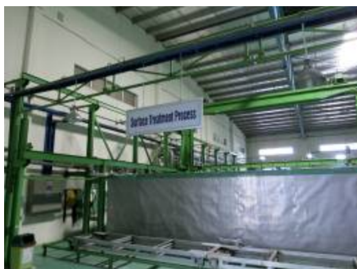
写真 3.5.3 化成皮膜処理設備
