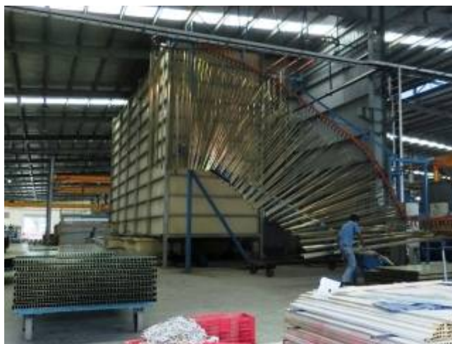
写真 3.3.3 化成皮膜処理設備
