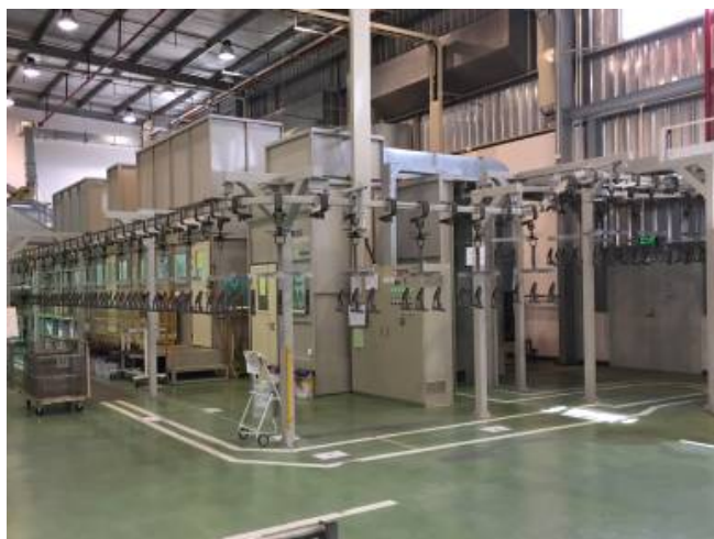
写真 3.2.5 溶剤塗装設備
