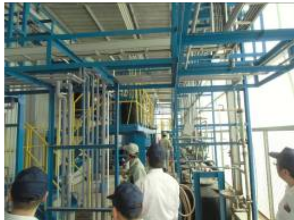
写真 3.2.4 排水処理設備
