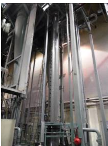
写真 3.1.3 粉体塗装ブース
