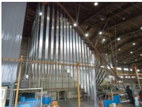
写真 3.2.1 縦吊り塗装設備①
