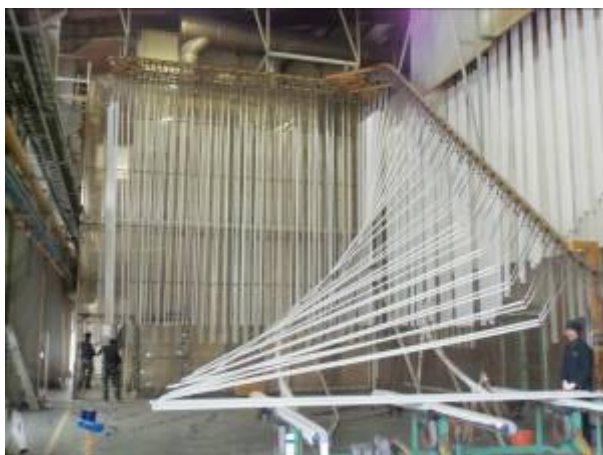
写真 3.2.2 縦吊り塗装設備②
